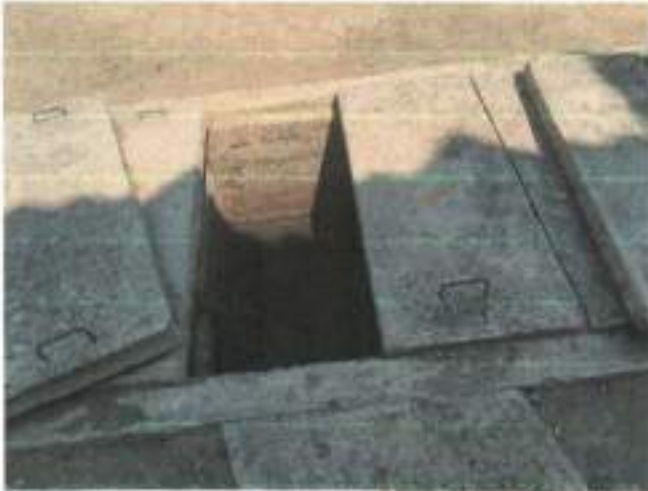
La tubería del drenaje esta en malas condiciones (roto)
